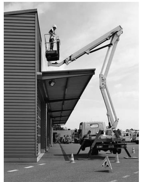
Bild 8: Der Arbeitsplatz ist so abzusichern, dass Passanten nicht in den Gefahrenbereich der Hubarbeitsbühne treten.
