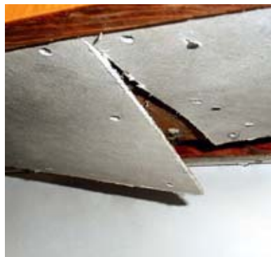
Asbesthaltige Leichtbauplatten als Brandschutz
