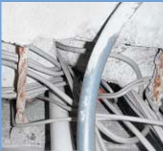
Brandabschottung mit Asbestkissen
