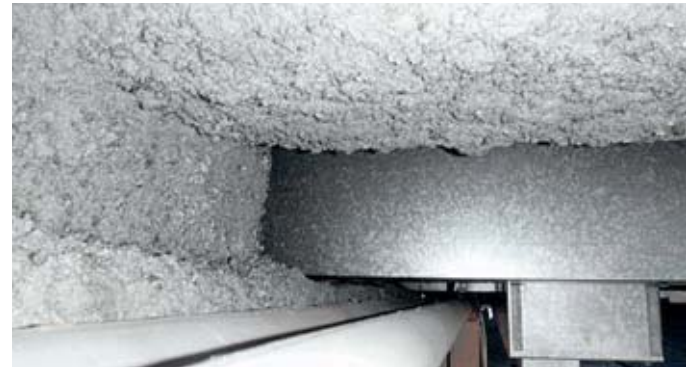
Spritzasbest als Brandschutz an Metallträger
