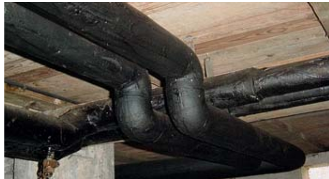
Rohrleitung mit asbesthaltigem Bitumenanstrich
