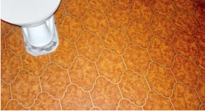
Mehrschichtige asbesthaltige Bodenbeläge; Cushion Vinyl
