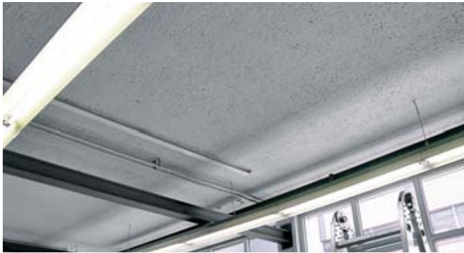
Spritzasbestbelag an Decke
