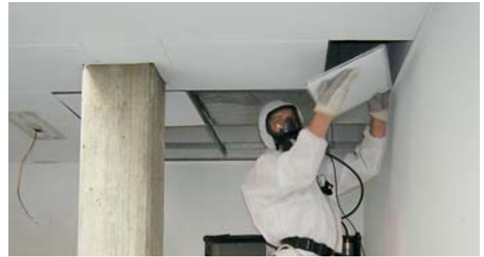
Entfernen nur durch anerkanntes Asbestsanierungsunternehmen
