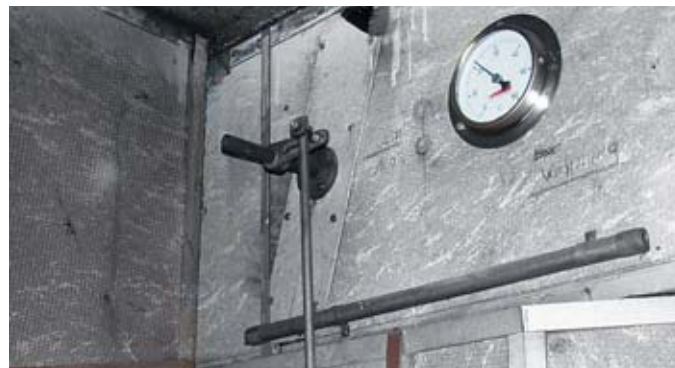
Lüftungskanal aus Asbestzementplatten
