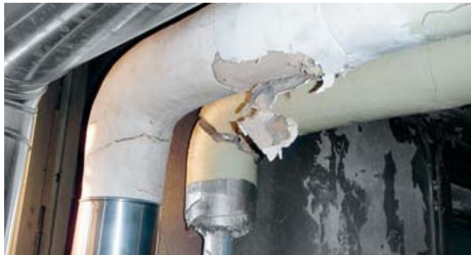
Rohrleitung mit asbesthaltigem Mörtel
