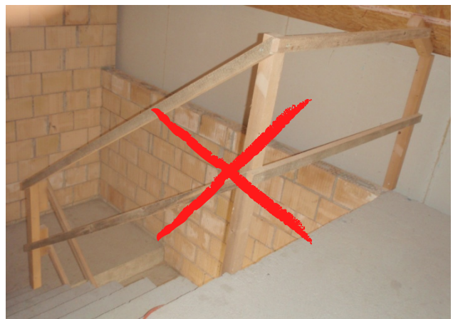
Bild 2 Dachlatten als Seitenschutzbauteile (hier im Treppenhaus) sind verboten.
