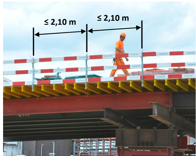
Bild 1 Seitenschutz mit rot-weissen Absperrlatten: maximaler Pfostenabstand 2,10 m
